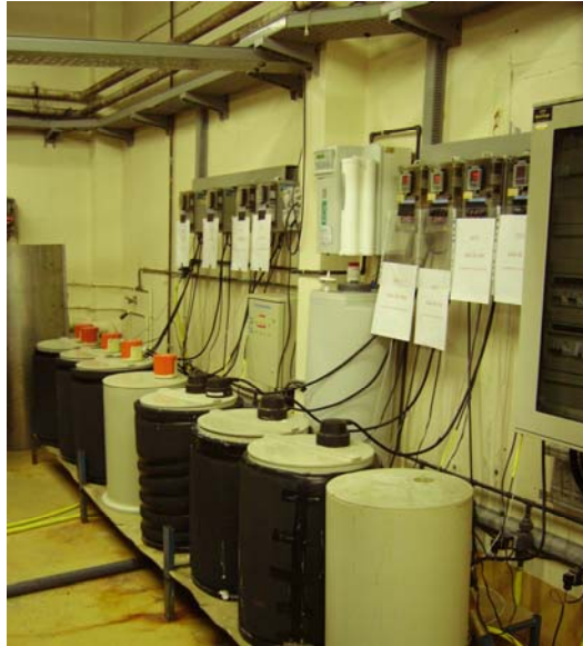
Figure 104 Caissons à eau renouvelée : eau de mer et eau déionisée (1bar)
