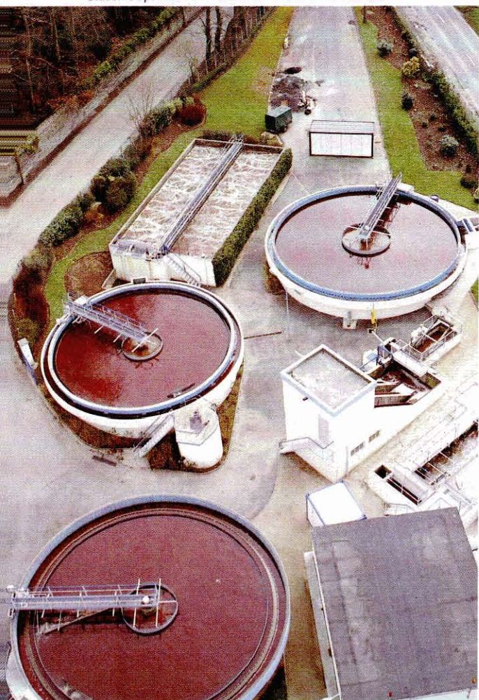
Station d'épuration d'effluents des abattoirs de Morlaix.
