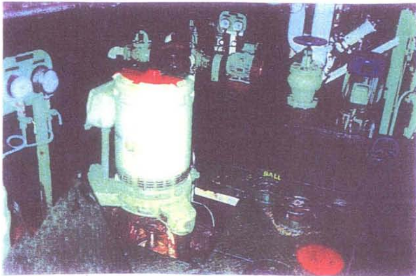
Fig.7: Pompe du circuit de ballastage dans la salle des machines(RORO de 90m)
