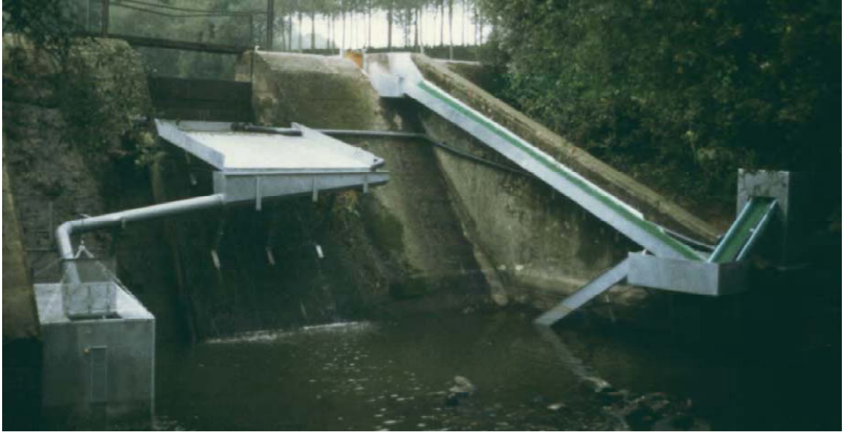
Figure 4. Barrage du Pont es Omnes (4 m de hauteur) équipé d'une passe-piège de montaison (en rive gauche) et d'un piège de dévalaison (en rive droite).
