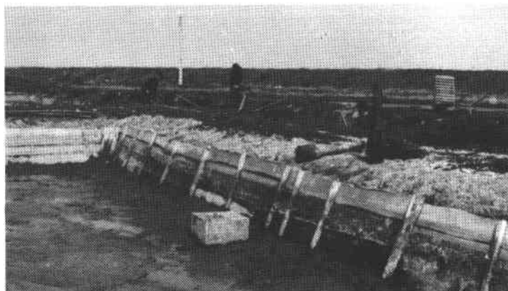
Fig. 7. — L'extrémité d'une claire et son système d'alimentation « dérase » en béton et « bondon » de fermeture sur la berge (photo Robert).
