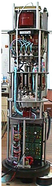
Fig. 7 : Electronique de puissance 5 kVA
