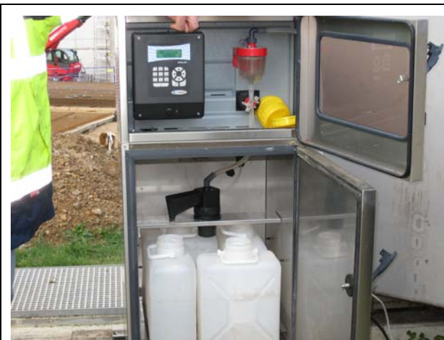
Figure 6 : Photo du préleveur automatique de la SAUR 2 en entrée de la station de lagunage
