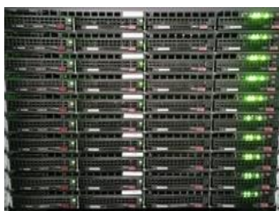
Figure 7-4 : serveurs de service
