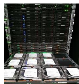
Figure 7-8 : stockage associé au web, un tiroir sorti
