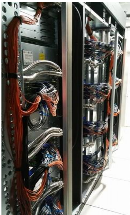
Figure 7-9- : switches infiniband et cablage dans l'ICE XA
