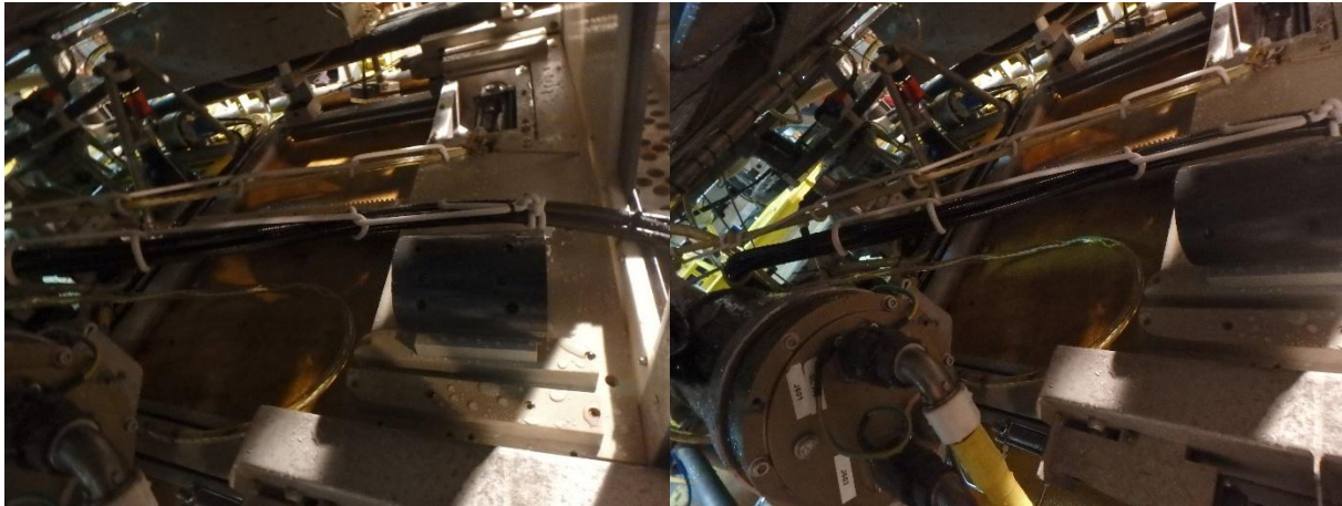
Figure 3 : branchements des câbles hydrauliques en parallèle des câbles pour caméra 4K
