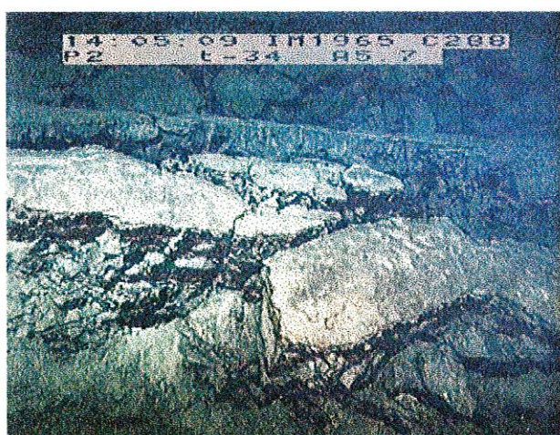
démantèlement en bordure d'une fissure ouverte
