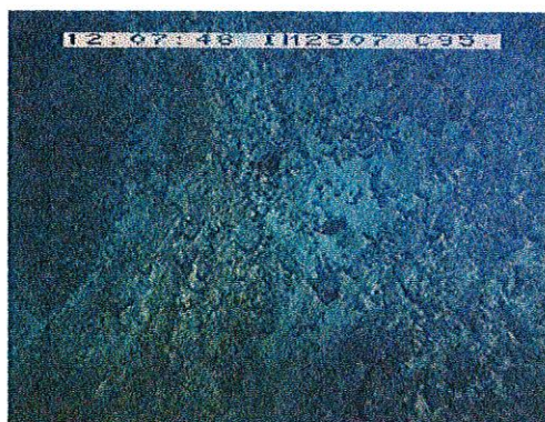
Eboulis repris par un arrachement, et éboulis oxydé sous-jacent
