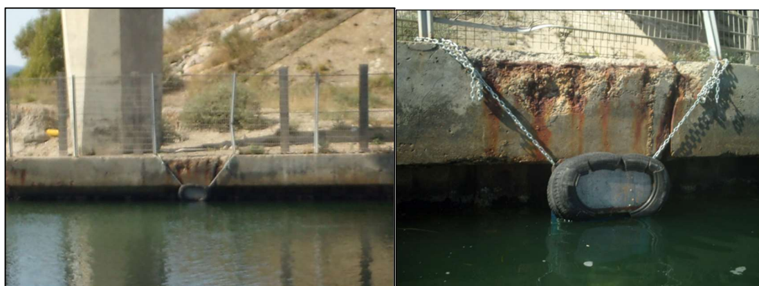
Figure 2 : (gauche) Localisation de l'appareil ADCP en contre-bas du quai sous le pont de la D627. (droite) Structure contenant l'appareil ADCP et sa centrale d'acquisition (source des photos : Hydriad Eau et Environnement).
