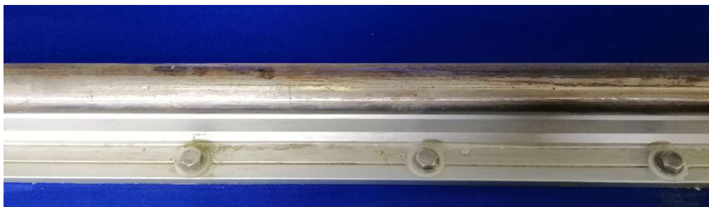
Fig.6 : Etat corrodé des rails en fin de mission
