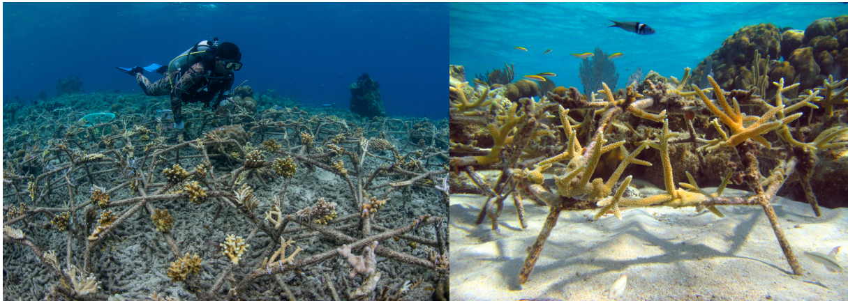
Figure 40 : Mise en œuvre des reef stars pour la restauration en milieu coralien sur des zones fortement impactées (source : https://www.buildingcoral.com/our-solution ).
