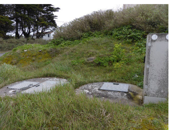
Figure 21 : poste de relèvement (PR)
